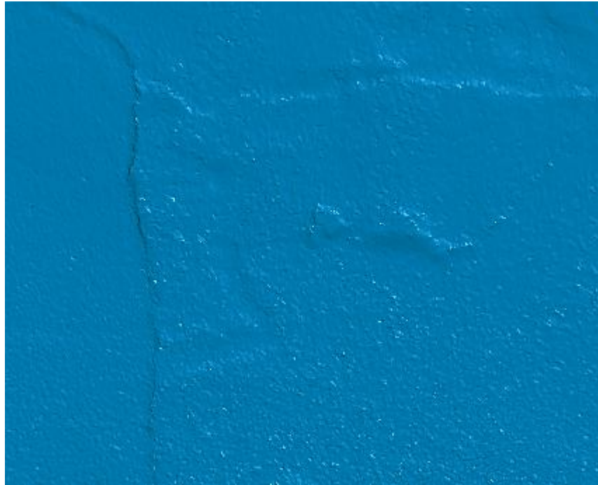
Εικόνα 4.16: Ρηγματώσεις στη συμβολή των δύο οδών
