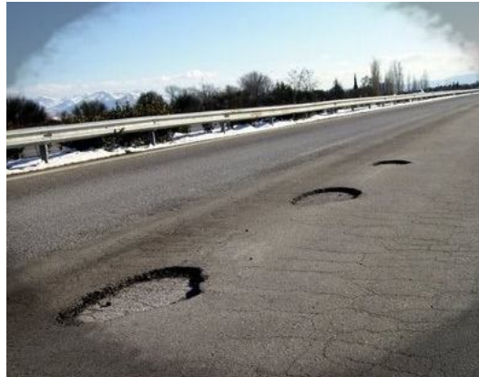
Εικόνα 2.2 : Λακούβες και ρηγματώσεις στο οδόστρωμα ( Πηγή : Google)
