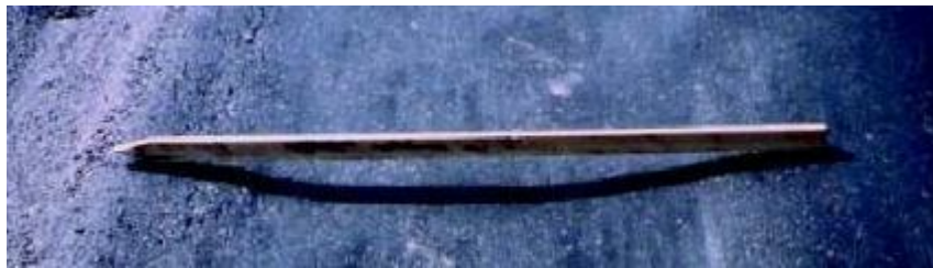
Εικόνα 2.3 : Αυλάκωση οδοστρώματος ( Πηγή : http://www.hellaskps.gr/ )
