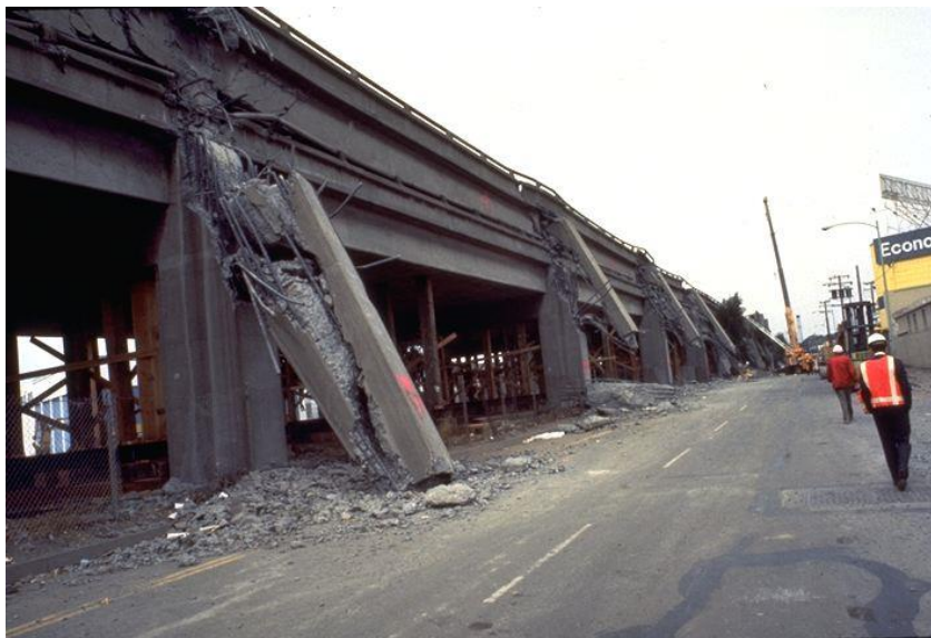
φωτ.1 Loma Prieta κατάρρευση τμήματος οδικής γέφυρας (1989)
