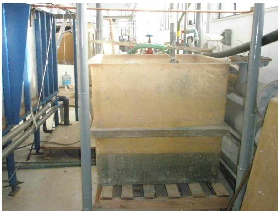
Σχήμα 3.5 Δεξαμενή παρασκευής διαλύματος.
