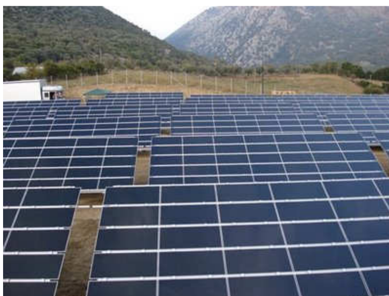
Σχήμα 1.2- Φωτοβολταϊκό Πάρκο στην Κύπρο
