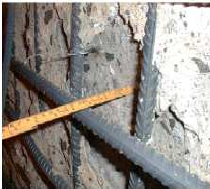
Εικόνα 2.6: Εικόνα αποφλοίωσης σκυροδέματος μετά από πυρκαγιά
