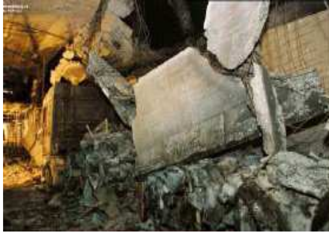
Εικόνα 2.2: Εικόνες καταστροφής της επένδυσης της σήραγγας
