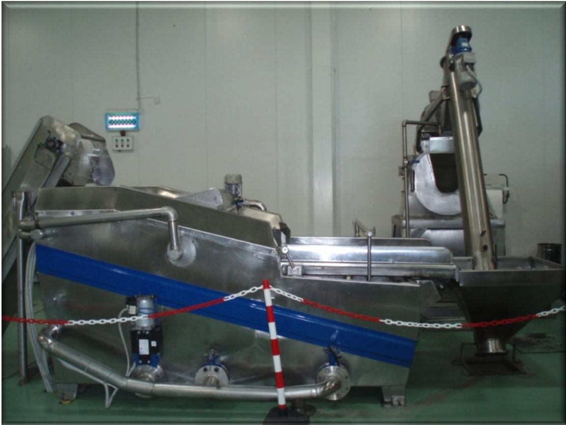
Εικόνα 5-18: Σύστημα πλυντηρίου – σπαστήρα
