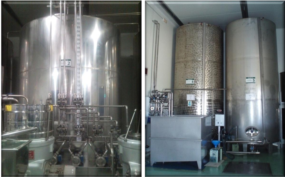
Εικόνα 5-32: Δεξαμενή 2 αποθήκευσης ελαιολάδου κοινής άλεσης – Χώρος παράδοσης ελαιολάδου και δεξαμενή παραλαβής
