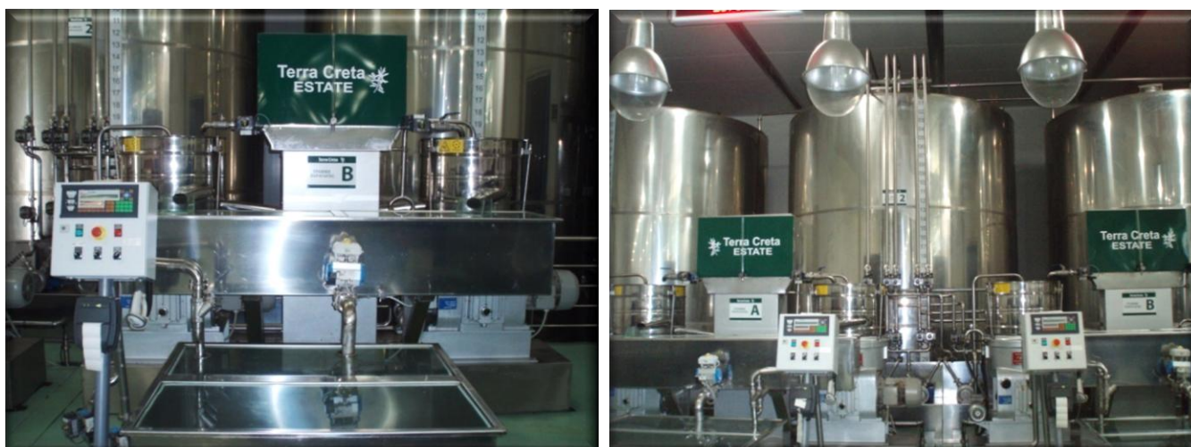
Εικόνα 5-30: Οι διαχωριστήρες της γραμμής B και το σύστημα δεξαμενών μπροστά τους – Οι τρεις δεξαμενές αποθήκευσης του ελαιολάδου κοινής άλεσης
