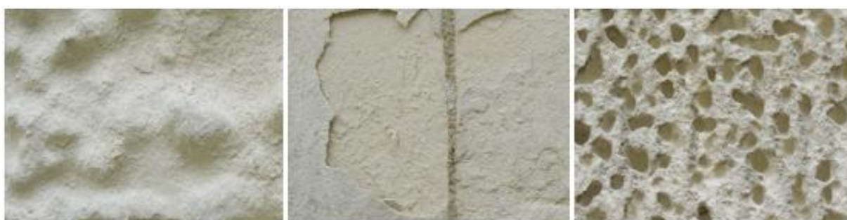
Figure 78 Trois états des maladies des pierres : efflorescences de la pierre, desquamation de la surface et creusement d'alvéoles.
