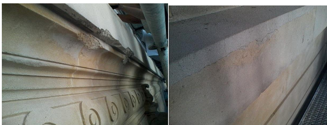
Figure 95 Pierre à remplacer
