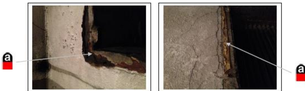
Figure 34 Joints « jaunes » amiantés
