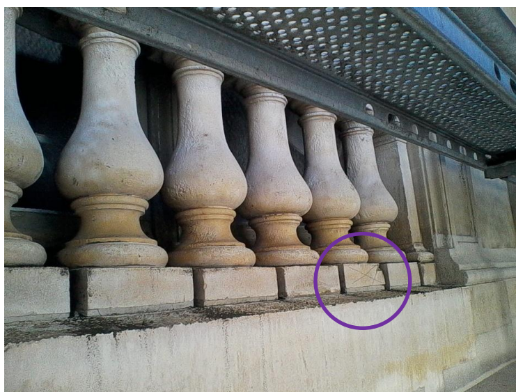
Figure 93 Balustre à remplacer
