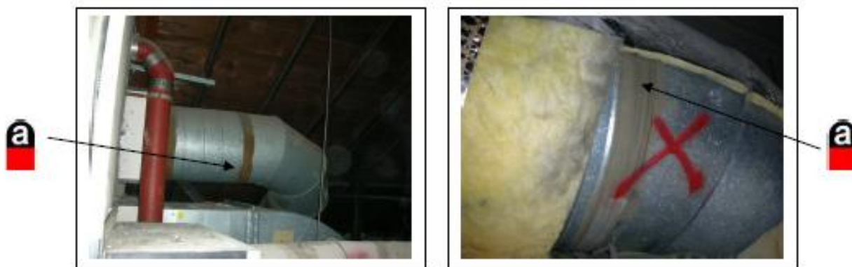
Figure 32 Joints « Marron » amiantées
