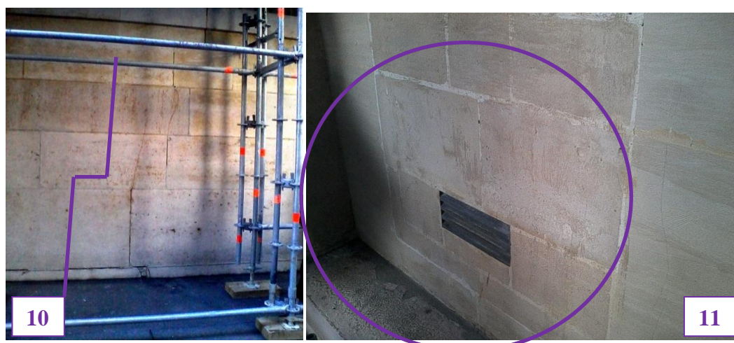
Figure 99 Fissuration en façade et pierre à remplacer
