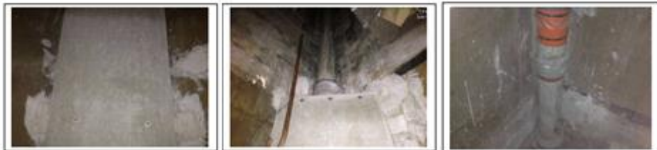
Figure 31 Conduits et plaque en fibrociment amiantés
