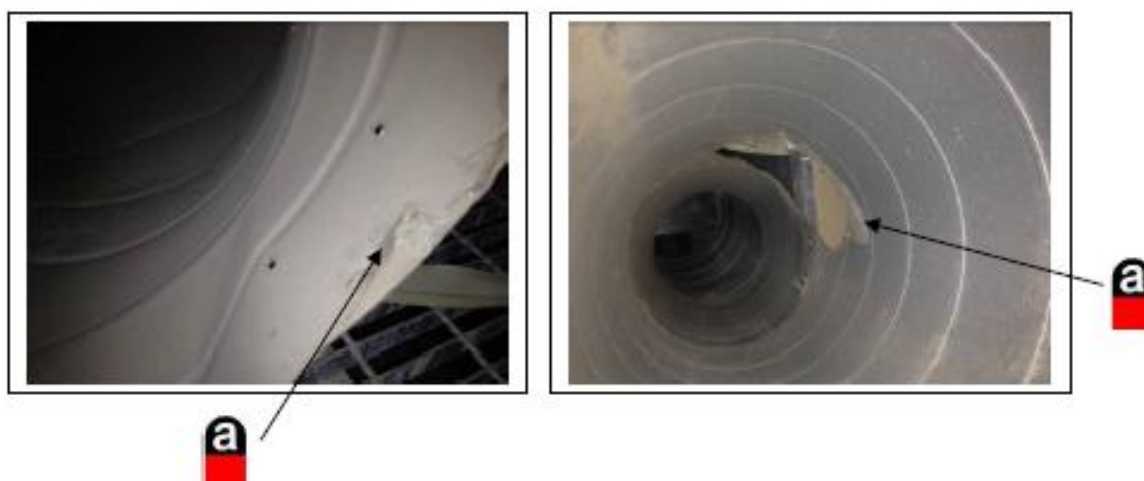
Figure 33 Joints « beiges » amiantées
