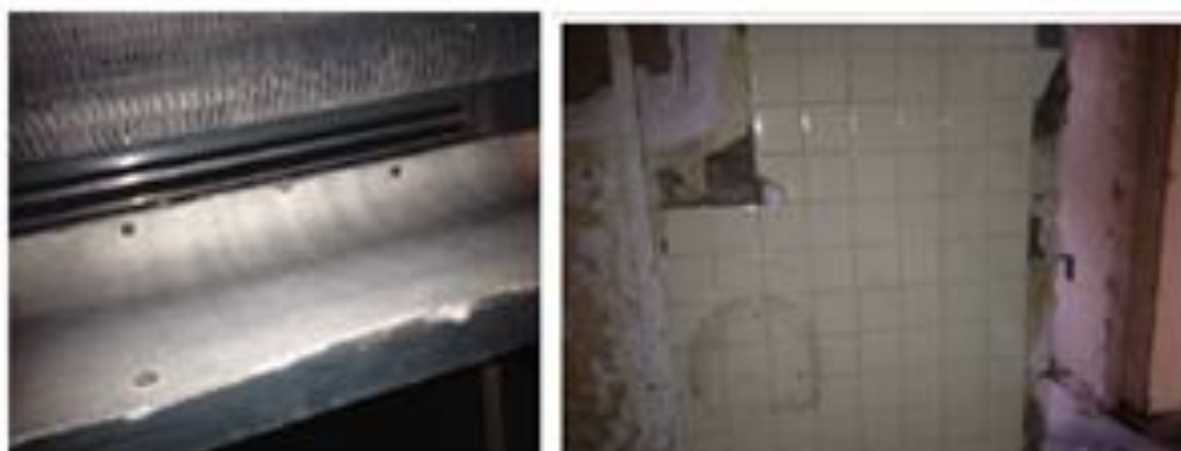
Figure 36 Plaques cartonées et colle faïence amiantées
