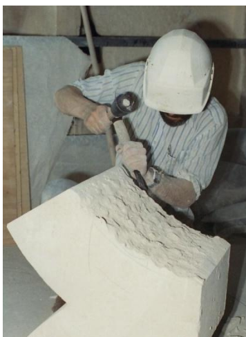
Figure 104 La taille de parements de pierre s'effectue à l'outil manuel pour rassurer un résultat le plus proche de l'apparence du parement existant conservé
