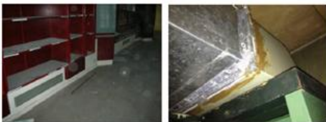
Figure 35 Joint type "Mastic" sur conduit métallique
