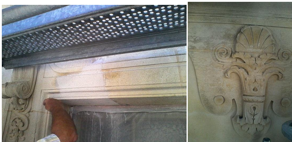
Figure 91 Jambages de baies : à prévoir remplacement de la partie existante et ragréage
