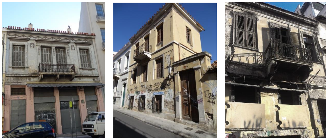
Εικόνα 6-7: Χαρακτηριστικά διατηρητέα με βάση την όψη τους (μέτρια, κακή και πολύ κακή κατάσταση – από αριστερά προς δεξιά) Πηγή: Προσωπικό αρχείο
