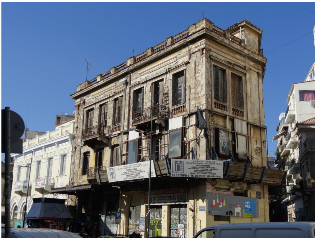
Εικόνα 4-11: Διατηρητέο προς αξιοποίηση στην οδό Ερμού 92 και Πιττακού (στο ισόγειο λειτουργούσε μαγαζί, οι όροφοι είναι σε κακή κατάσταση τόσο εσωτερικά όσο και εξωτερικά) Πηγή: προσωπικό αρχείο
