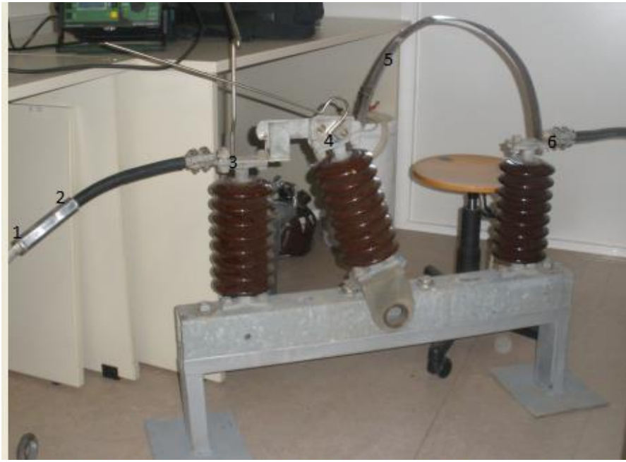
Εικόνα 3.1-2: Κύκλωμα μέτρησης 6 θερμών σημείων Σημείο 1: αγωγός AAAC 185 mm 2 Σημείο 2: σύνδεσμος AAAC 185 mm 2 με αγωγό Cu 70 mm 2 Σημείο 3: επαφή εισόδου του αποζεύκτη Σημείο 4: επαφή εξόδου του αποζεύκτη Σημείο 5: έλασμα αεροδιακόπτη Σημείο 6: σύνδεσμος αεροδιακόπτη με AAAC 185 mm 2
