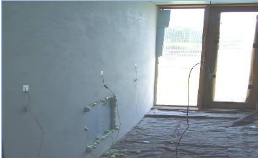
Σχήμα 4.2.1.6.1.9: Δυτικό δωμάτιο του αδιαβατικού κελιού δοκιμής – πρόσοψη γυψοσανίδας PCM, [23]
