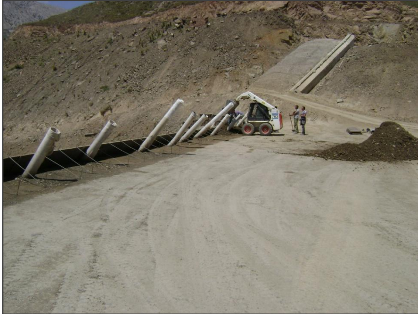
Εικόνα 5.14 Αποστραγγιστικοί σωλήνες Κόρη-Γεφύρι
