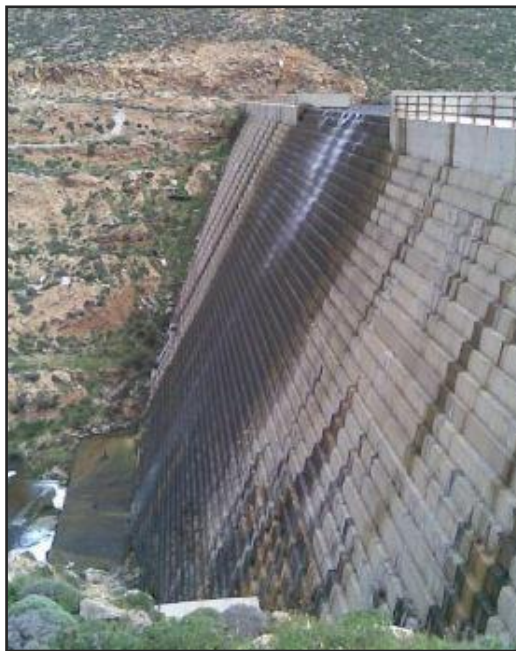
Εικόνα 5.4 Διαρροές στο σώμα του φράγματος.
