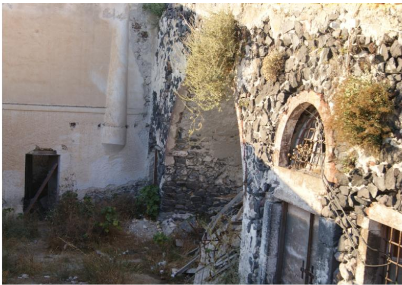
Εικ. 1.4: Εγκαταλελειμμένο κτίριο στα Φηρά. Διακρίνεται η χρήση μαυρόπετρας για τη δομή φερόντων τοίχων [99]
