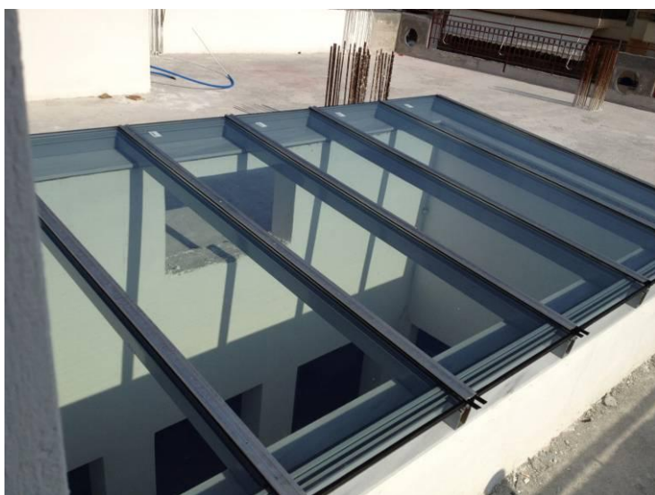
Εικ.6.7: Φωταγωγός με ενεργειακά υαλοπετάσματα [106]
