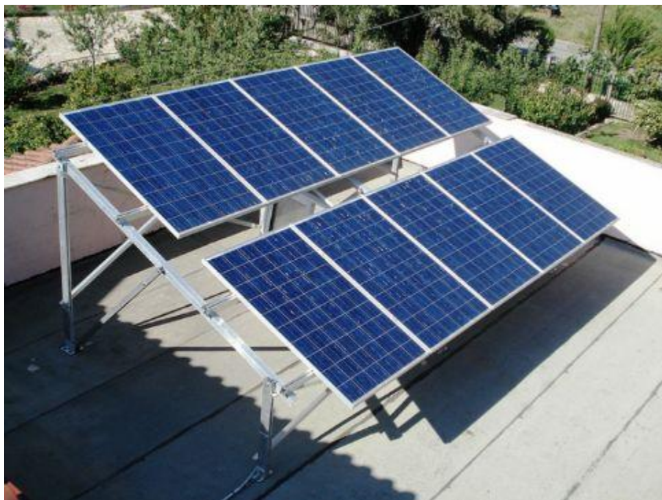
Εικ. 7.1: Οικιακά φωτοβολταϊκά πλαίσια σε δώμα κατοικίας [25]
