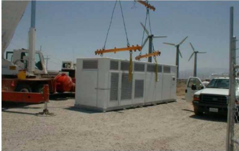
Σχ.32 Εγκατάσταση μονάδας ηλεκτρόλυσης κοντά στο αιολικό πάρκο του Palm Springs (California)
