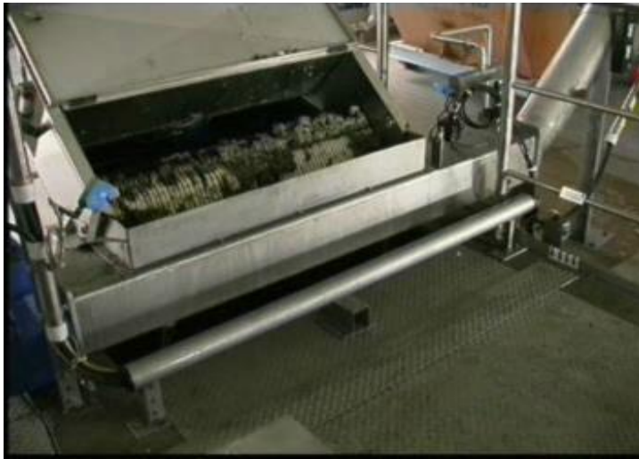
Εικόνα 39: Τυπική μονάδα εσχάρωσης, Πηγή: Ε.Ε.Λ της Ανθούπολης
