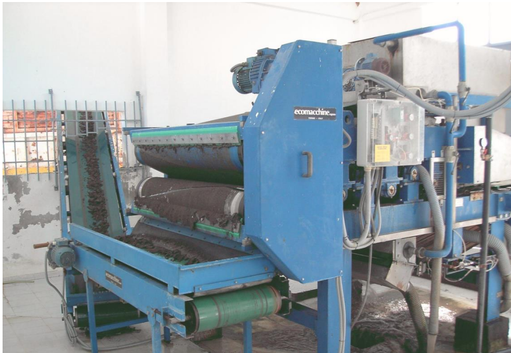
Εικόνα 45: Μονάδα αφυδάτωσης (ταινιοφιλτρόπρεσες), Πηγή: http://www.deyaprevezas.gr/index.php/biologikos-katharismos
