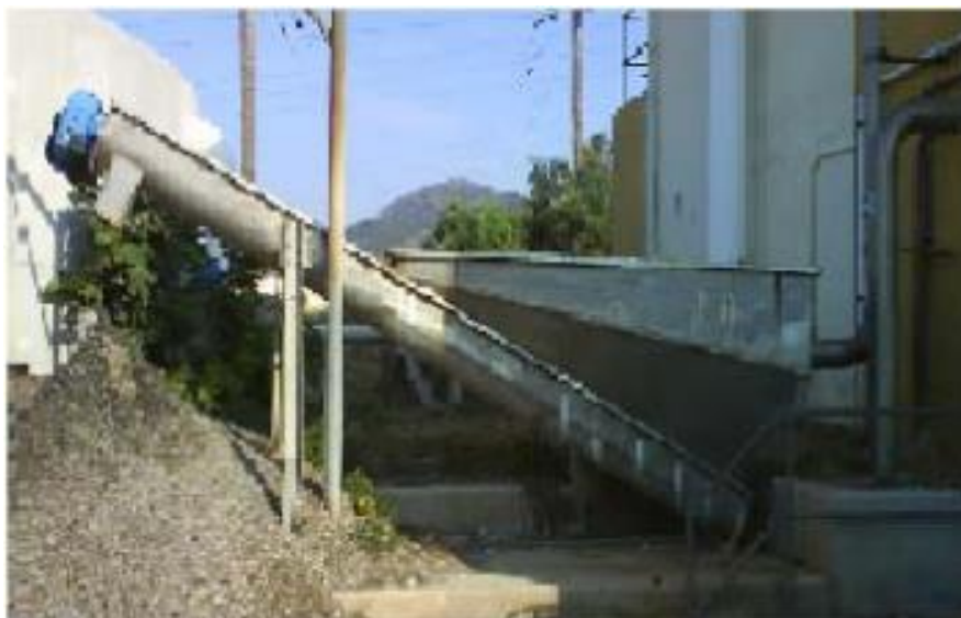
Εικόνα 40: Τυπικός κάδος εσχαρισμάτων, Πηγή: Από Ε.Ε.Λ. Λαυρίου
