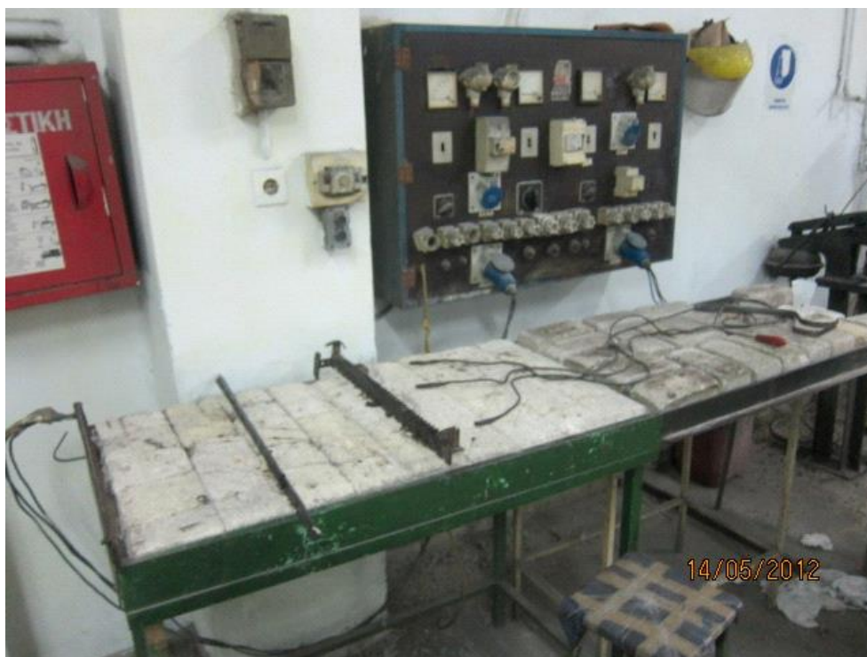
Εικόνα 22 Ο ηλεκτρολογικός πίνακας και ο πυρίμαχος πάγκος υπερθέρμανσης
