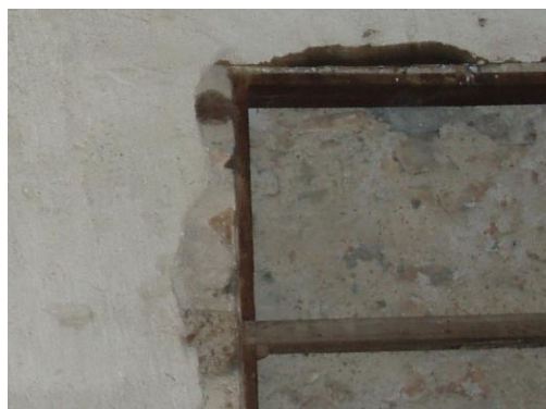
Σχ.5.4.2 Αποκόλληση επιχρίσματος
