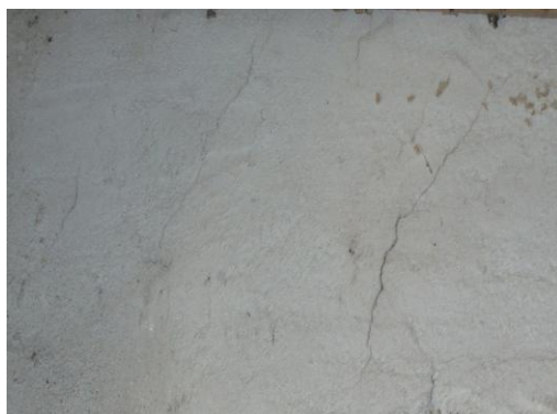
Σχ. 5.4.1 Φθορά επιχρίσματος
