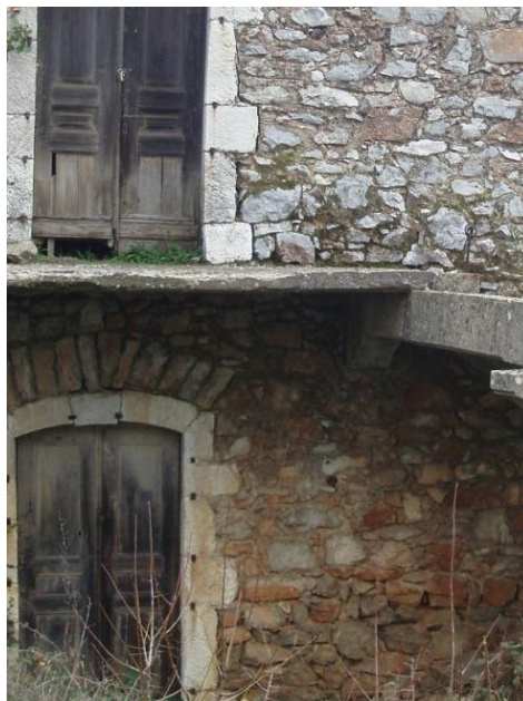
Σχ. 5.2.7 Εμφανής η διάβρωση της τοιχοποιίας του ισογείου
