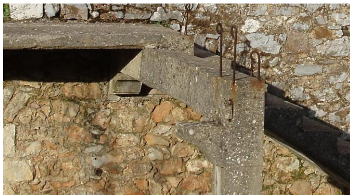
Σχ. 5.2.3 Επιφανειακή φθορά σκυροδέματος και διάβρωση οπλισμού
