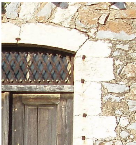
Σχ. 5.4.3 Εμφανής η διάβρωση των τζινετιών
