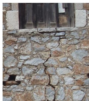
Σχ.5.3.2 Ρωγμές σε ποδιά παραθύρου της νότιας όψης
