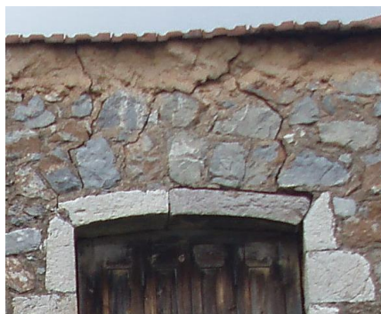
Σχ.5.3.1 Ρωγμές σε υπέρθυρο παραθύρου της νότιας όψης
