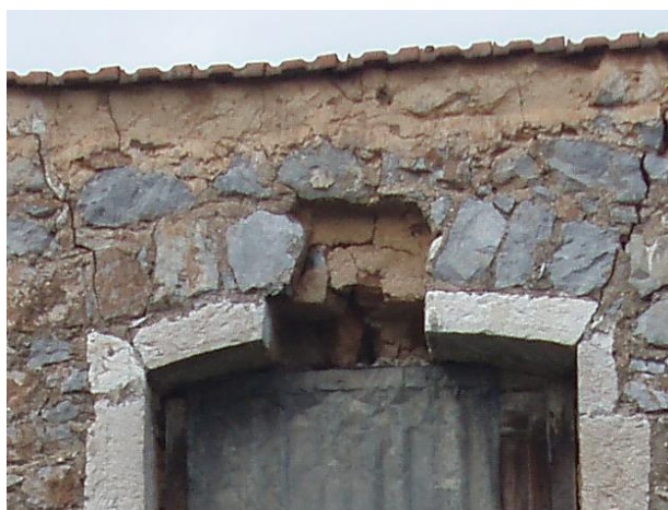
Σχ. 5.3.4 Τοπική κατάρρευση της τοιχοποιίας και πτώση κλείδας στο υπέρθυρο της θύρας του ορόφου στη νότια όψη
