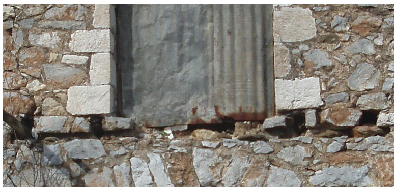
Σχ. 5.2.2 Δοκοθήκες έδρασης εξώστη και τοπική αποδιοργάνωση κατωφλιού θύρας
