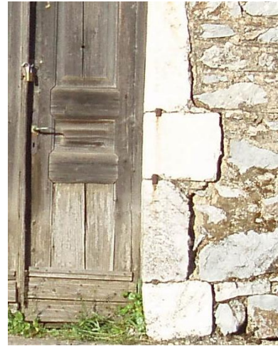
Σχ.5.3.6 Αποκόλληση λίθων στη λαμπάδα της θύρας του ορόφου στη δυτική όψη
