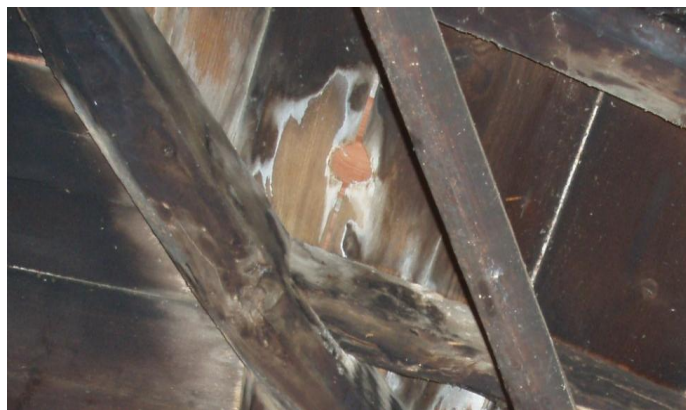
Σχ. 5.2.1 Εμφανές το κεραμίδι λόγω φθοράς σανιδώματος
