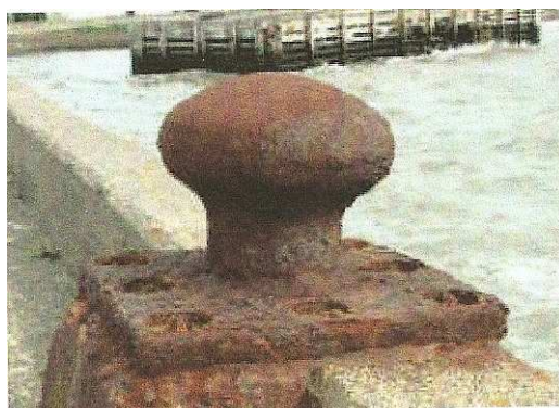
Φωτογραφία 1.1: Αποτέλεσμα ομοιόμορφης διάβρωσης.
