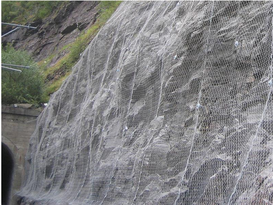
Φωτογραφία 7.3 Μεταλλικό πλέγμα συγκράτησης βραχοτεμαχίων
