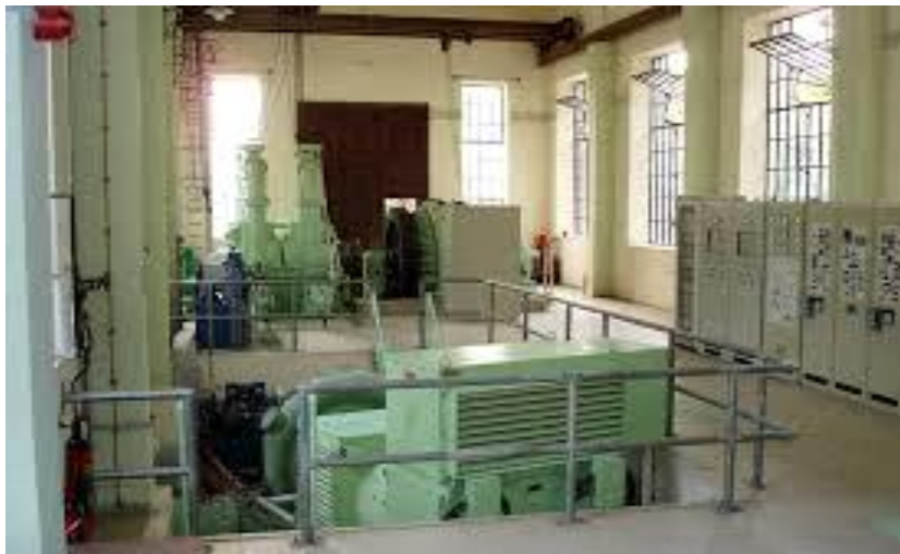
Υδροηλεκτρικός σταθμός του Γλαύκου.
