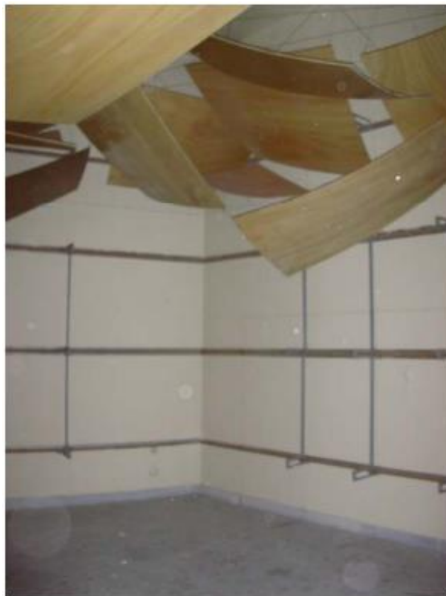
Εικόνα 5.5: Αναρτημένα, ελαφρώς κυρτωμένα φύλλα κόντρα πλακέ στην αίθουσα αντήχησης του Εργαστηρίου Ηχοτεχνίας του Ε.Μ.Π. [50]
