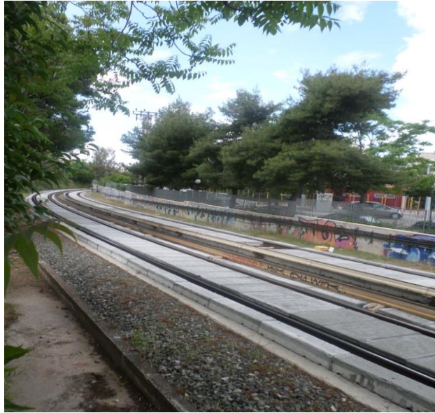
Εικόνα 2.9: Φωτογραφία τμήματος του δικτύου του Η.Σ.Α.Π. στη Χ.Θ. 18+300. Διακρίνονται οι ηχοαπορροφητικές πλάκες στις γραμμές ανόδου και καθόδου
