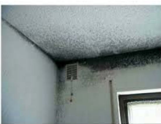
Εικόνα 4.50: Υγρασία από συμπύκνωση υδρατμών στη γωνία της οροφής δωματίου τελευταίου ορόφου (πηγή: http://www.asterpap.gr/ )
