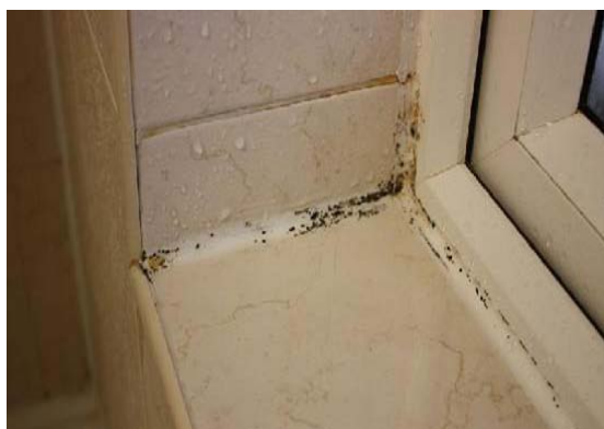
Εικόνα 4.49: Υγρασία και μούχλα από συμπύκνωση υδρατμών λουτρού χωρίς καλό αερισμό (πηγή: http://www.buildnet.gr/ )
