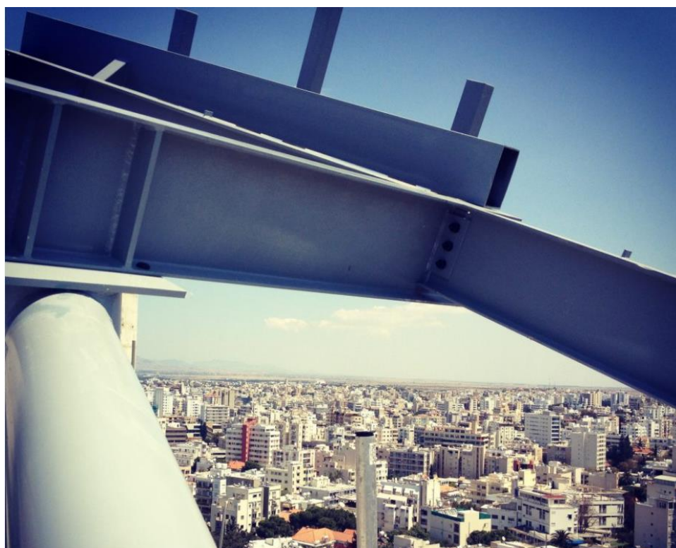
Εικόνα 3.2 Ο ίδιος τύπος σύνδεσης χρησιμοποιείται και σε άλλα σημεία της κατασκευής (σκελετός υποστήριξης των φωτοβολταϊκών της οροφής).
