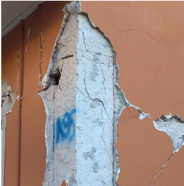
Φωτογραφία 26: Υποσύλωμα Κ35. Βλάβη βαθμού Δ.
