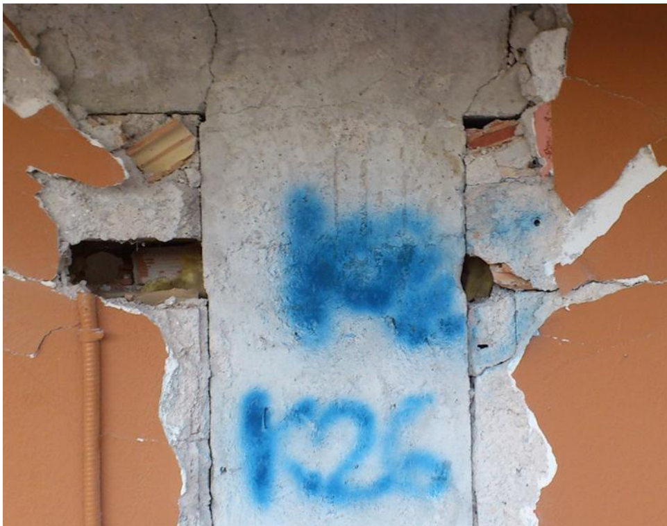
Φωτογραφία 18: Υποσύλωμα K26. Βλάβη βαθμού Α.
