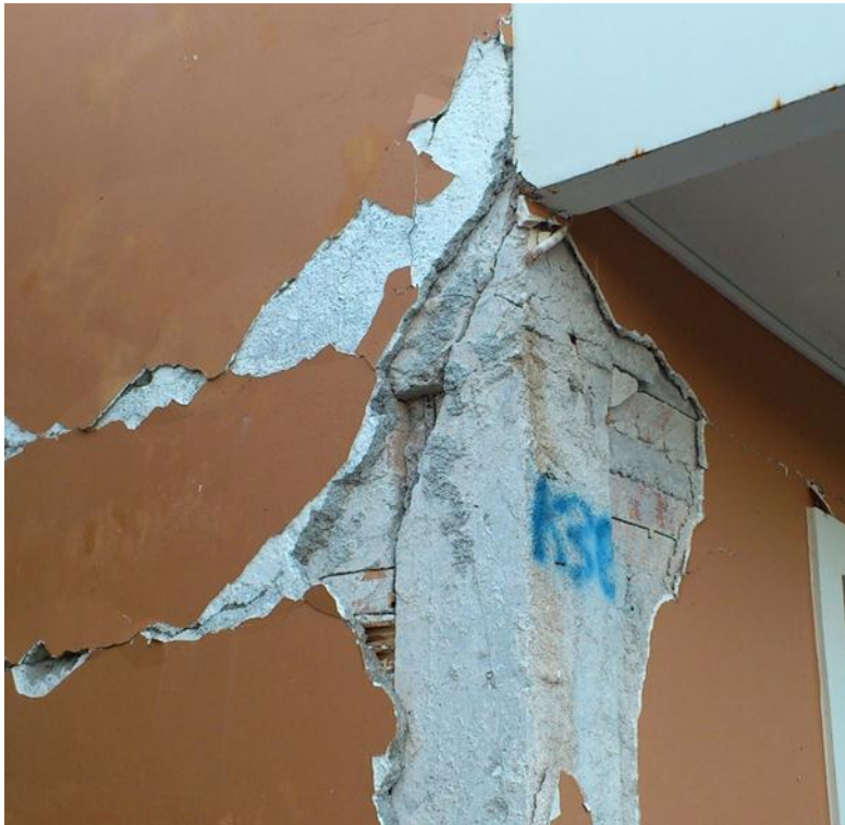
Φωτογραφία 21: Υποσύλωμα Κ30. Βλάβη βαθμού Δ.
