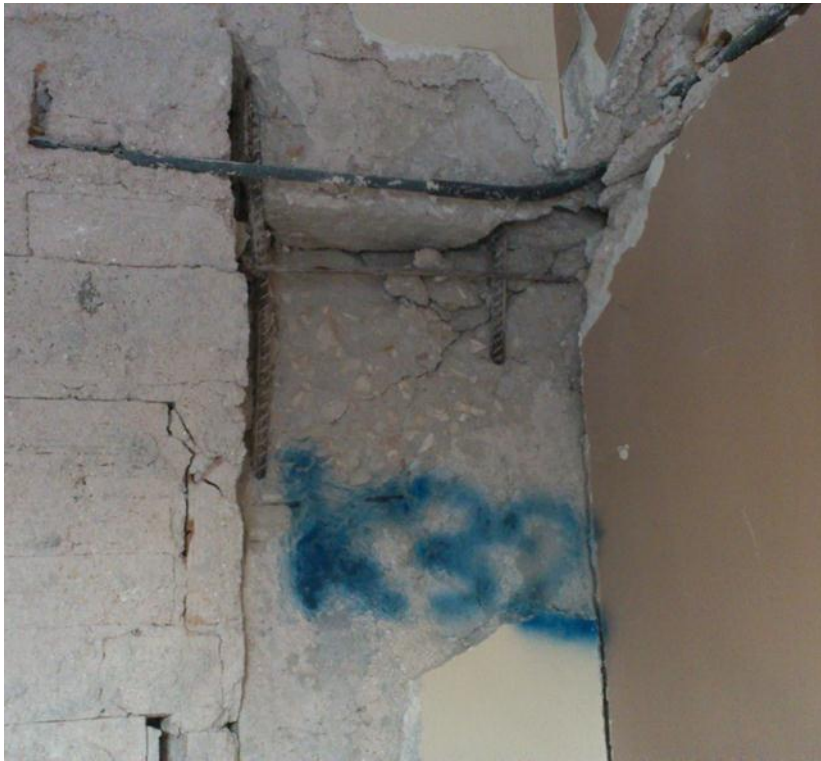
Φωτογραφία 23: Υποσύλωμα Κ32. Βλάβη βαθμού Δ.
