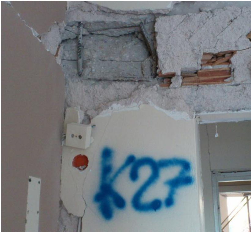
Φωτογραφία 19: Υποσύλωμα K27. Βλάβη βαθμού Δ.
