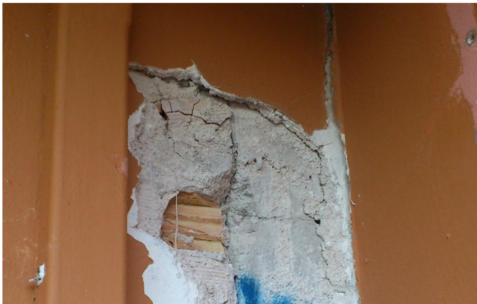
Φωτογραφία 16: Υποσύλωμα Κ18. Βλάβη βαθμού Α.
