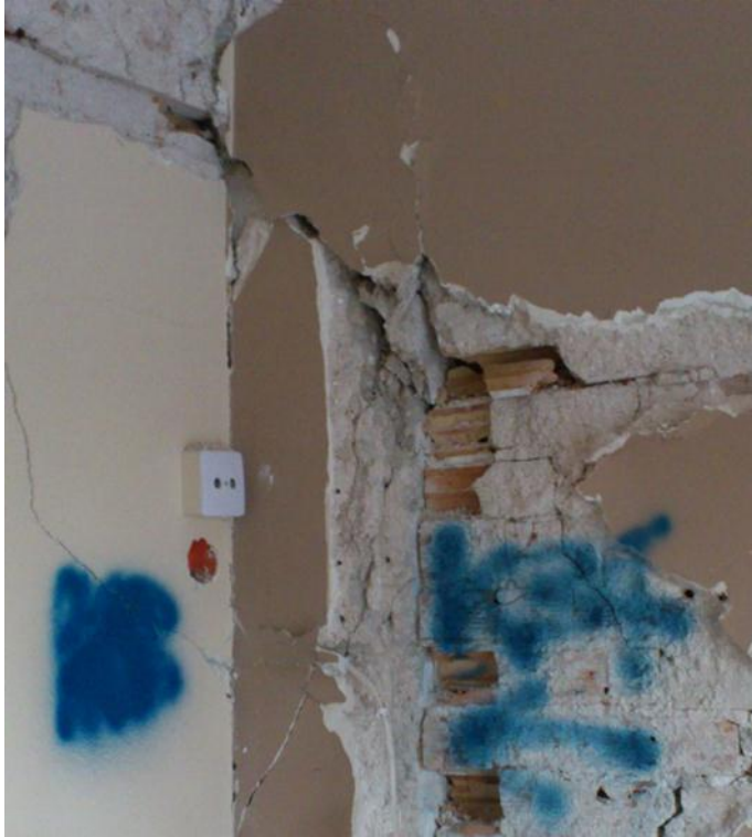
Φωτογραφία 25: Υποσύλωμα Κ34. Βλάβη βαθμού Δ.
