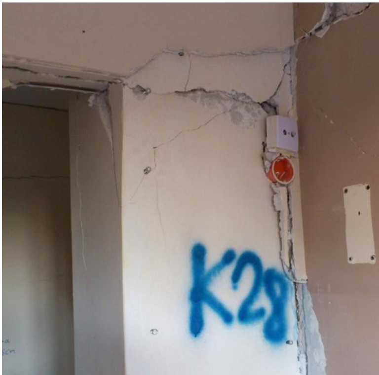
Φωτογραφία 20: Υποσύλωμα K28. Βλάβη βαθμού Β2 (α).
