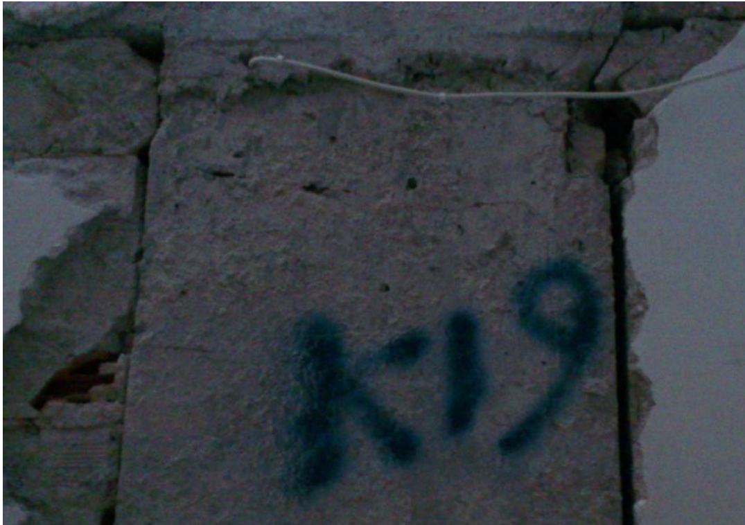
Φωτογραφία 17: Υποσύλωμα K19. Βλάβη βαθμού Α.
