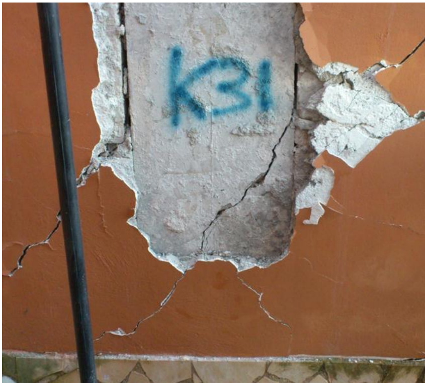
Φωτογραφία 22: Υποσύλωμα Κ31. Βλάβη βαθμού Β2 (γ).
