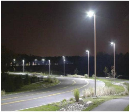
Εικόνα 4.7: Τα LED στον οδοφωτισμό.
