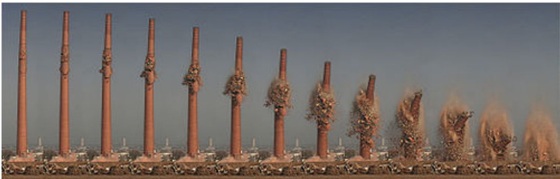
Εικόνα 3: Κατεδάφιση καμινάδας από κεραμόπλινθους στο εργοστάσιο της "Henninger Brewery" στη Φρανκφούρτη το 2006 (πηγή: wikipedia http://en.wikipedia.org/wiki/Building_implosion )
