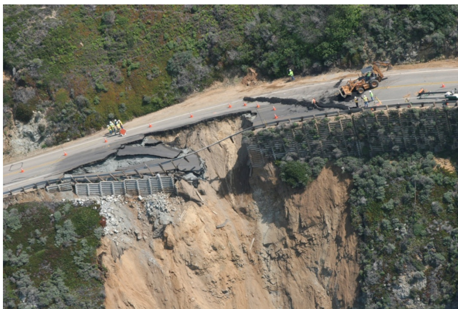
Σχήμα 2: Καταστροφικές συνέπειες της αστοχίας πρανούς σε κατασκευές πολιτικού μηχανικού (California, 2011).
