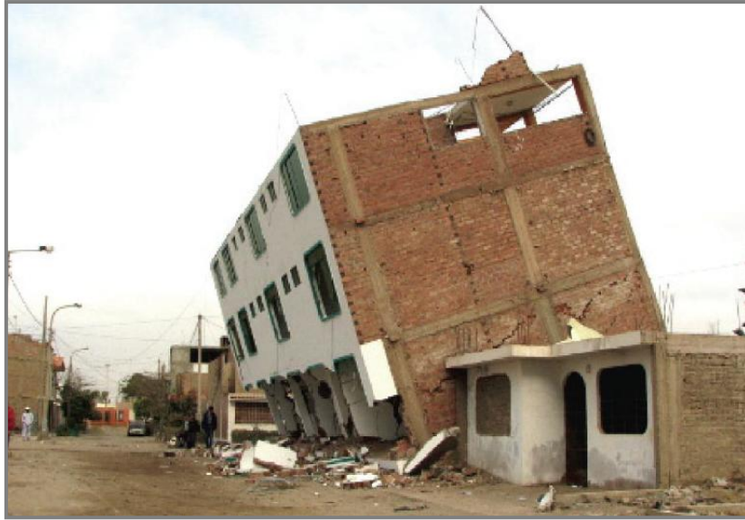
Σχήμα 4. Κατάρρευση κτιρίου από οπλισμένο σκυρόδεμα κατά την διάρκεια σεισμού που συνέβη στο Περού το 2007, λόγω της παρουσίας μαλακού ορόφου στο ισόγειο (DO SOO MOON, 2012)
