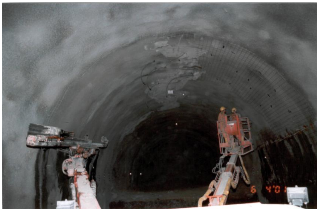
Ρωγμές στην κλείδα της σήραγγας του δεξιου κλάδου χ.θ 13+340 - 13+390
