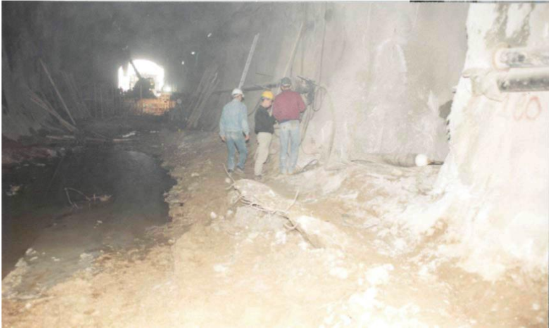
Νότιο Μέτωπο - Δεξιός Κλάδος: ανύψωση και θραύση στο invert.
