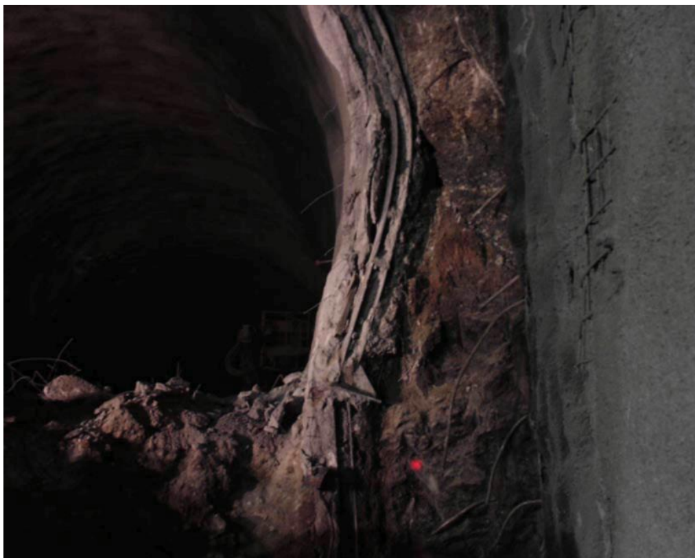
Ρωγμές στην επαφή Α' και Β' φάσης. Στρέβλωση πλαισίου.
