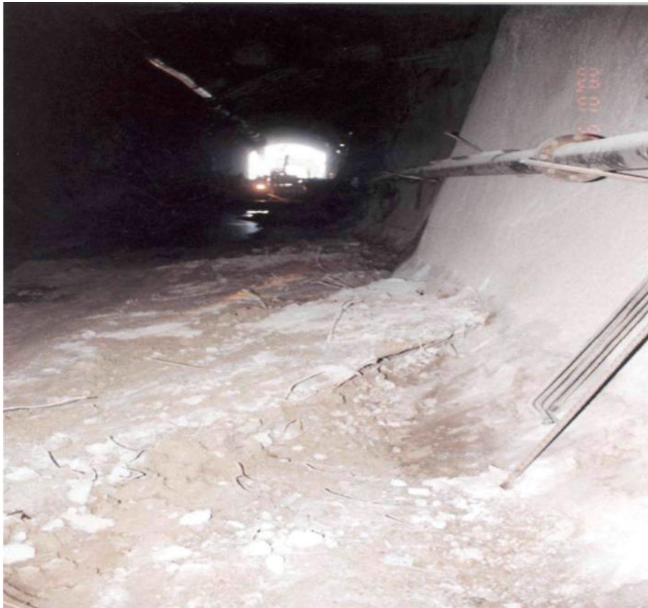
Νότιο Μέτωπο - Δεξιός Κλάδος: θραύση και αποκόλληση στη ραφή Β φάσης - invert.
