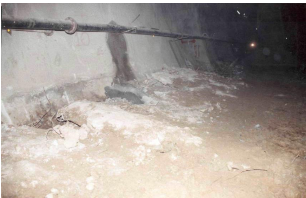
Νότιο Μέτωπο – Δεξιός Κλάδος: θραύση και αποκόλληση στη ραφή Β φάσης - invert.
