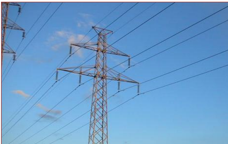
1-24 Καλώδια μεταφοράς ενέργειας
