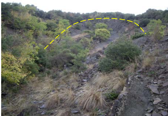
Εικόνα 6-19 : Επιφανειακή θραύση πρσανούς στον ιλυολιθικό φλύσχη της ευρύτερης περιοχής εισόδου της σήραγγας. Ο ιδιαίτερα ευνοϊκός προσανατολισμός των ψαμμικών στρώσεων, έχει αποτρέψει την πλευρική επέκταση του φαινομένου, όχι όμως και την αστοχία του ενδιάμεσου ιλυολιθικού υλικού
