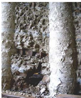
Εικόνα 6-16 : «Φέτα» ψαμμιτικού φλύσχη (1.00 x 6.00 x 0.40), που διατηρείται ευσταθής μεταξύ δύο πασσάλων της ενδιάμεσης συστοιχίας. Από το άνοιγμα στη βάση διακρίνεται το απέναντι διάζωμα της υπό κατασκευήν οδού
