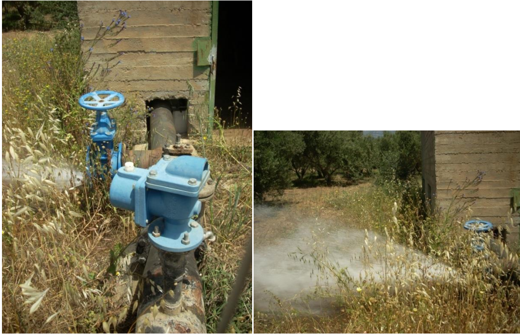
Εικόνα 5.8: Δικλείδα διακοπής νερού γεώτρησης.
