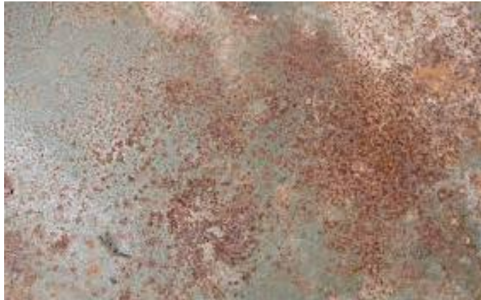
Εικόνα 26: Οξείδωση χάλυβα (σκουριά)
