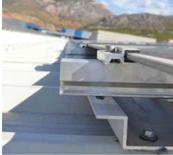
Εικόνα 15: Σύνδεση με το Φ/Β πλαίσιο
