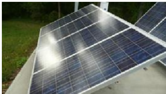
Εικόνα 10: Τυχούσες αντανακλάσεις σε φωτοβολταϊκό πλαίσιο
