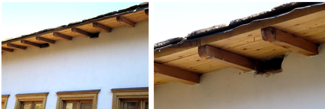
Εικόνα 24: Αυτοσχέδια ανοίγματα ακριβώς κάτω από τη στέγη με σκοπό να αεριστεί και να μη συσσωρευτεί μέσα υγρασία. Άποψη στέγης με τις τρύπες (αριστερά) και κοντινό πλάνο τρύπας (δεξιά).
