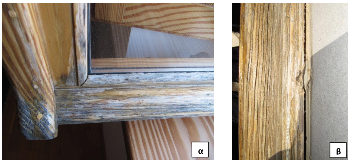
Εικόνα 22: α,β) Απόψεις διαβρωμένου παράθυρου, εξαιτίας των ακραίων καιρικών συνθηκών και της κακής συντήρησης. Πηγή: Προσωπικό φωτογραφικό αρχείο. Μέτσοβο, 2014.
