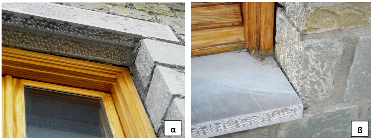
Εικόνα 20: α) Κακή συναρμογή του πλαισίου του κουφώματος με το πρέκι (υπέρθυρο) και την τοιχοποιία, β) Κακή συναρμογή της ποδιάς και του κουφώματος με την τοιχοποιία.
