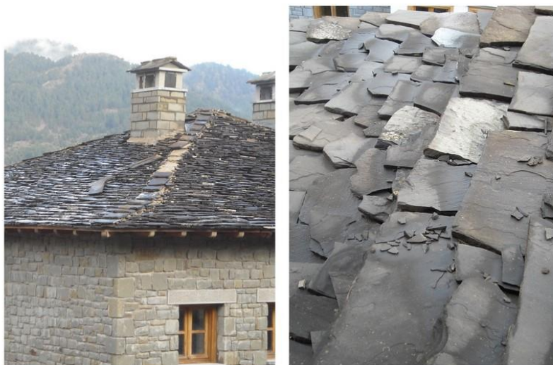
Εικόνα 23: Σχιστόπλακες που έσπασαν εξαιτίας των καιρικών συνθηκών. Άποψη στέγης (αριστερά) και θραύσματα σχιστολιθικών κεραμιδιών (δεξιά).
