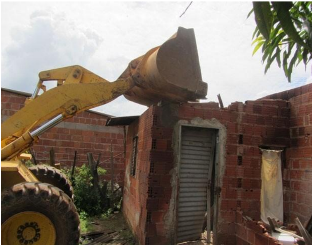
Εικόνα 8: Αυθαίρετο κτίσμα στην Πορτογαλία (ανακτήθηκε από www.g1.globo.com/distrito-federal/noticia/2011/09/fiscais-do-gdf-derrubam-construcoes-ilegais-em-vicente-pires.html )
