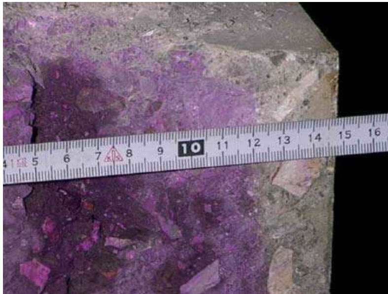
Σχήμα 31: Δοκίμιο σκυροδέματος το οποίο έχει ψεκάσθει με διάλυμα φαινολοφθαλεΐνης. Το τμήμα στο οποίο δεν παρουσιάζεται αλλαγή χρώματος (δεξιά) είναι ενανθρακωμένο (βάθος ενανθρακώσεως περίπου 3cm) Το αριστερά τμήματα (χρώματος ροζ - βυσσινί) δεν έχει ενανθρακωθεί.
