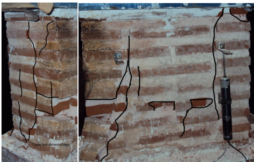
Εικόνα 3.7. Δοκίμιο MK 2 – Όψη C - Όψη B.
