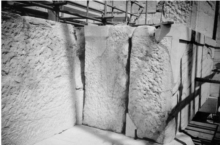
Εικόνα 1.18 Νότια όψη επιστυλίων ΟΕ2.2 και ΟΕ2.3 με εμφανή των μηχανισμό αστοχίας (φωτ. Ε.-Ε.Τουμπακάρη, από Μελέτη αποκαταστάσεως Οπισθονάου, τ.Π : Τεκμηρίωση & ποιοτική ερμηνεία βλαβών, ΥΣΜΑ (δακτυλογράφη), (2007α)
