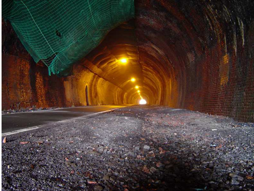
Εικόνα 2.2 Δομικές αστοχίες αήραγγας
