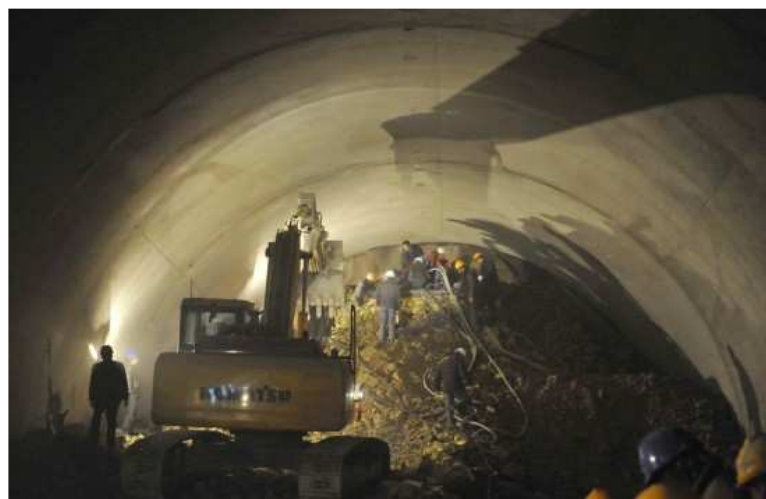
Εικόνα 2.1 Αστοχία μετώπου σήραγγας
