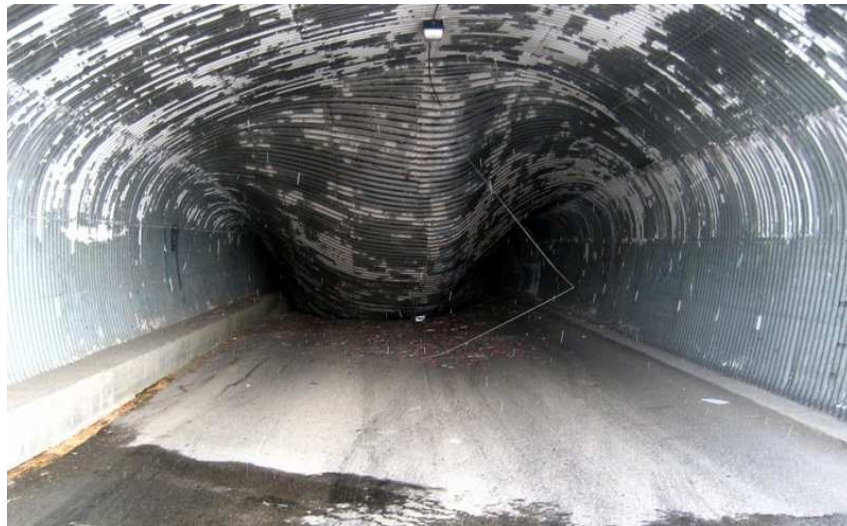
Εικόνα 2.3 Αστοχία σήραγγας λόγω καθιζήσεων
