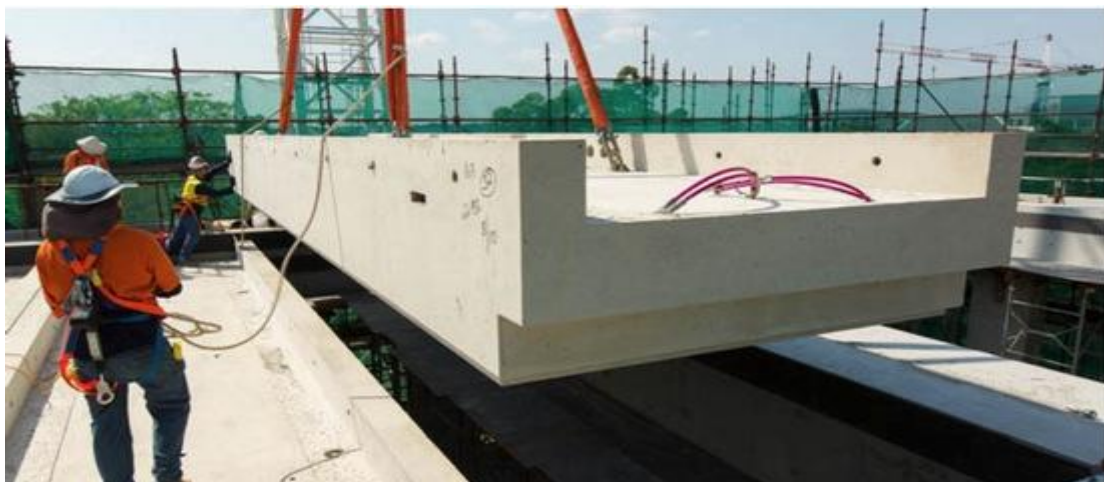
Εικόνα 3-30 Ένα από τα 33 προκατασκευασμένα πάνελ από γεωπολυμερές σκυρόδεμα με τα οποία κατασκευάστηκαν τα δάπεδα του κτιρίου CGI (Wagners).
