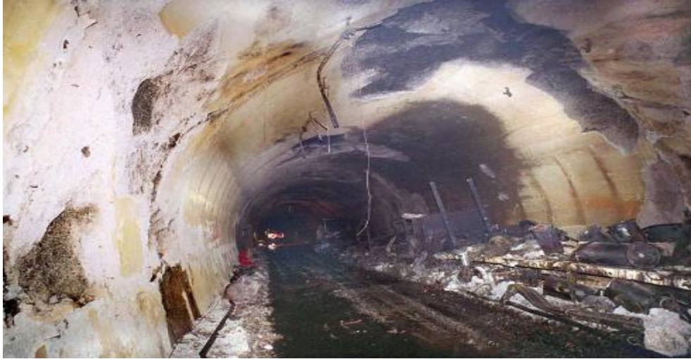
Εικόνα 2-1 Channel Tunnel μετά την πυρκαγιά του 1996
