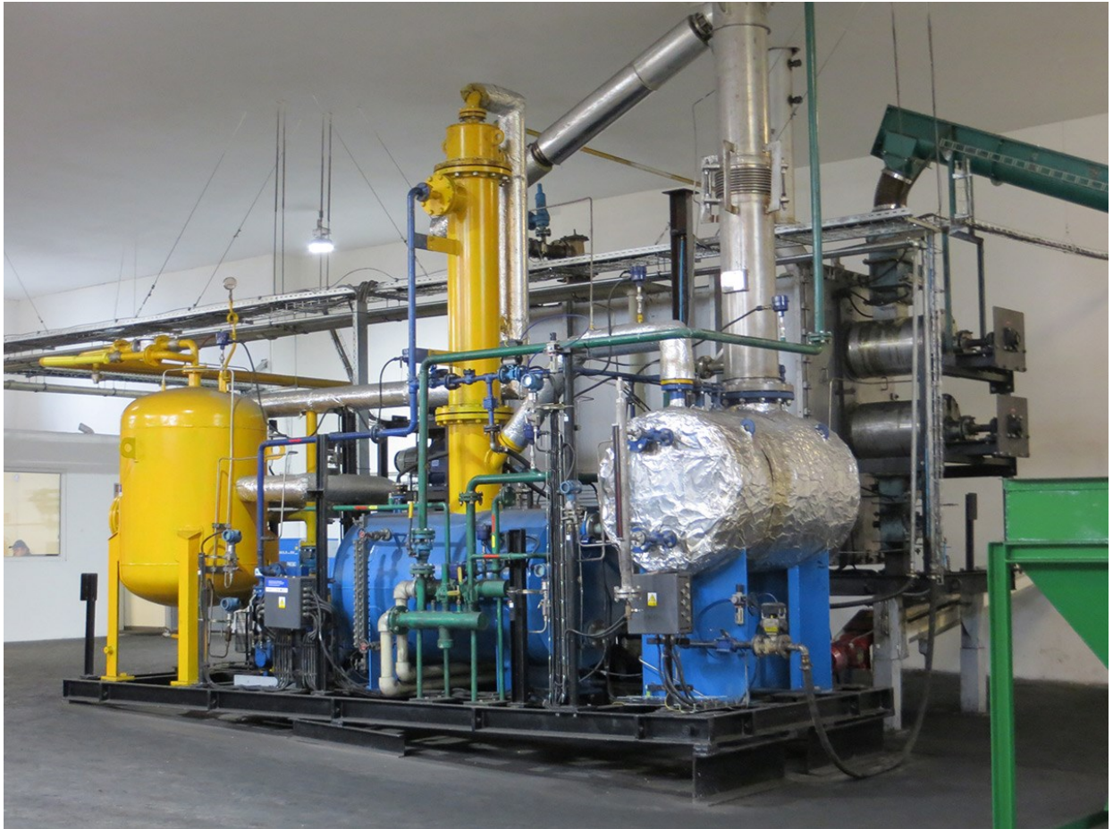
Εικόνα 19 : μονάδα πυρόλυσης M3RP στην Τσεχία [45]
