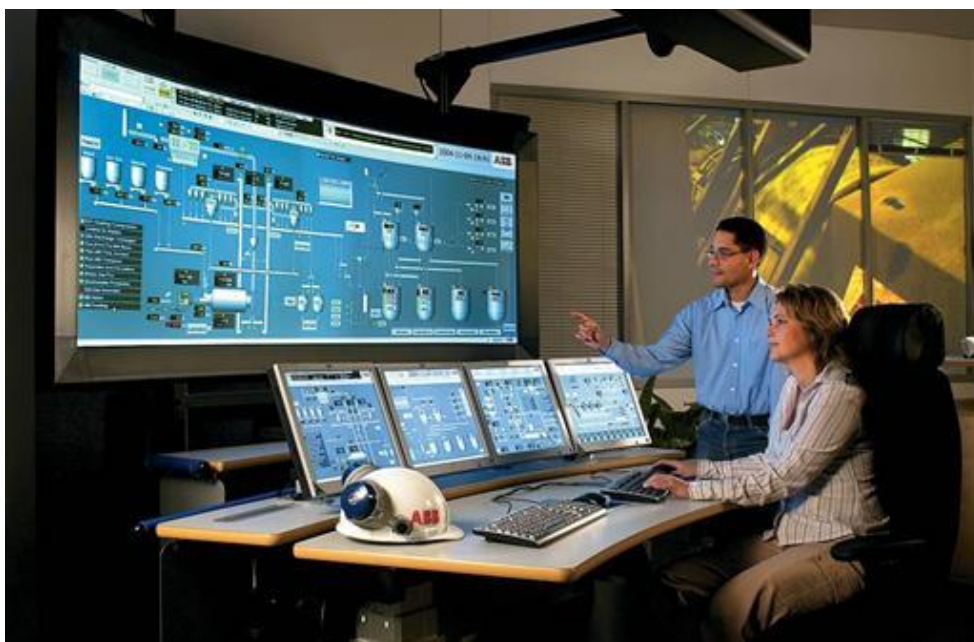
Σχήμα 2. 5 Κεντρικός σταθμός Scada
