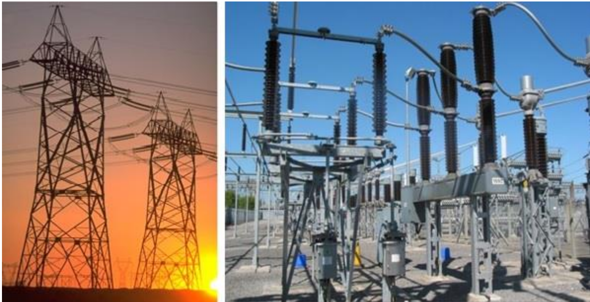
Σχήμα 1. 1 Γραμμές ΥΤ και Υποσταθμός Μεταφοράς ΥΤ
