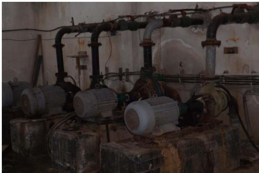
Φώτο Ε.10: Αντλίες εισόδου νερού στις δεξαμενές πόλης Αμαλιάδας
