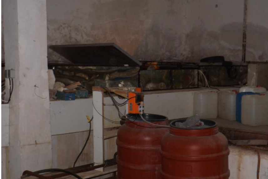
Φώτο E.11: Βαρέλια με NaOCl που χρησιμοποιείται για την χλωρίωση του νερού των δεξαμενών
