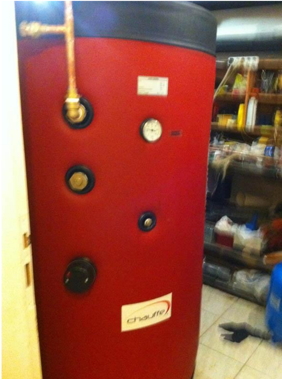
Σχήμα 5.20 : Εγκατεστημένο δοχείο Chauffe
