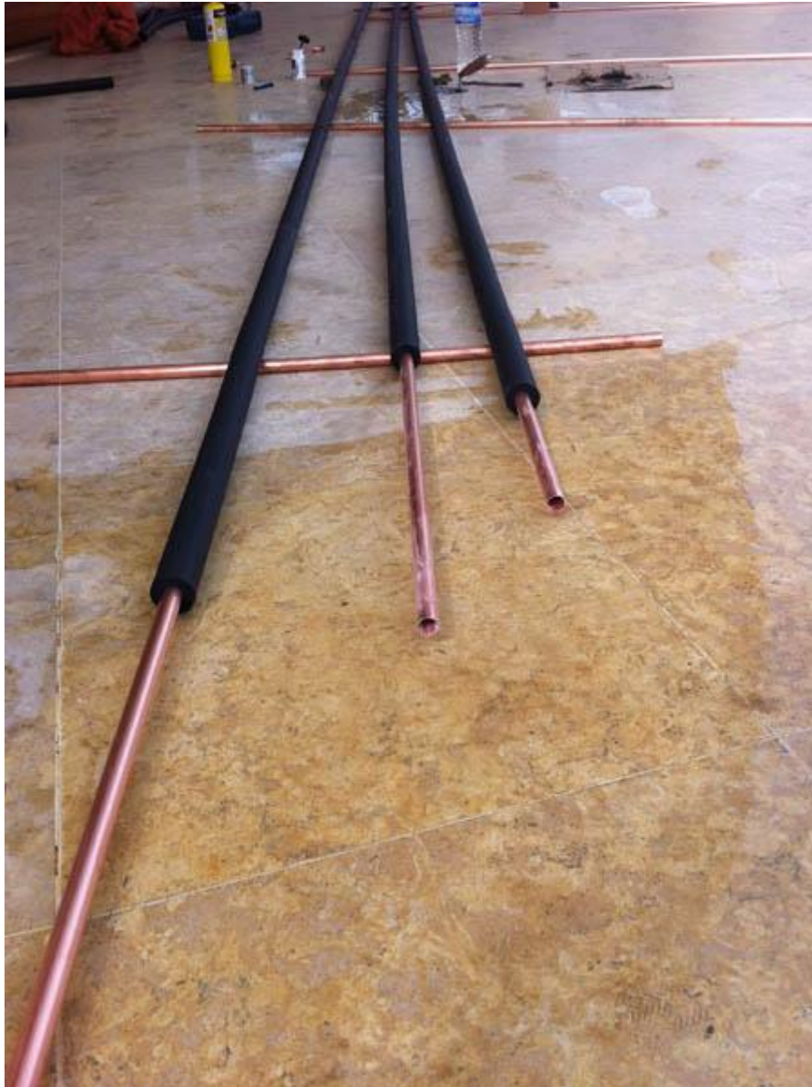
Σχήμα 5.25: Χαλκοσωλήνες εγκατάστασης μονωμένες με πετροβάμβακα
