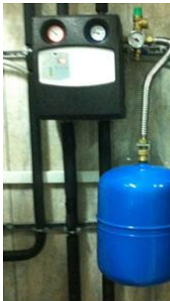
Σχήμα 5.17: Εγκατεστημένο σετ κυκλοφορητή
