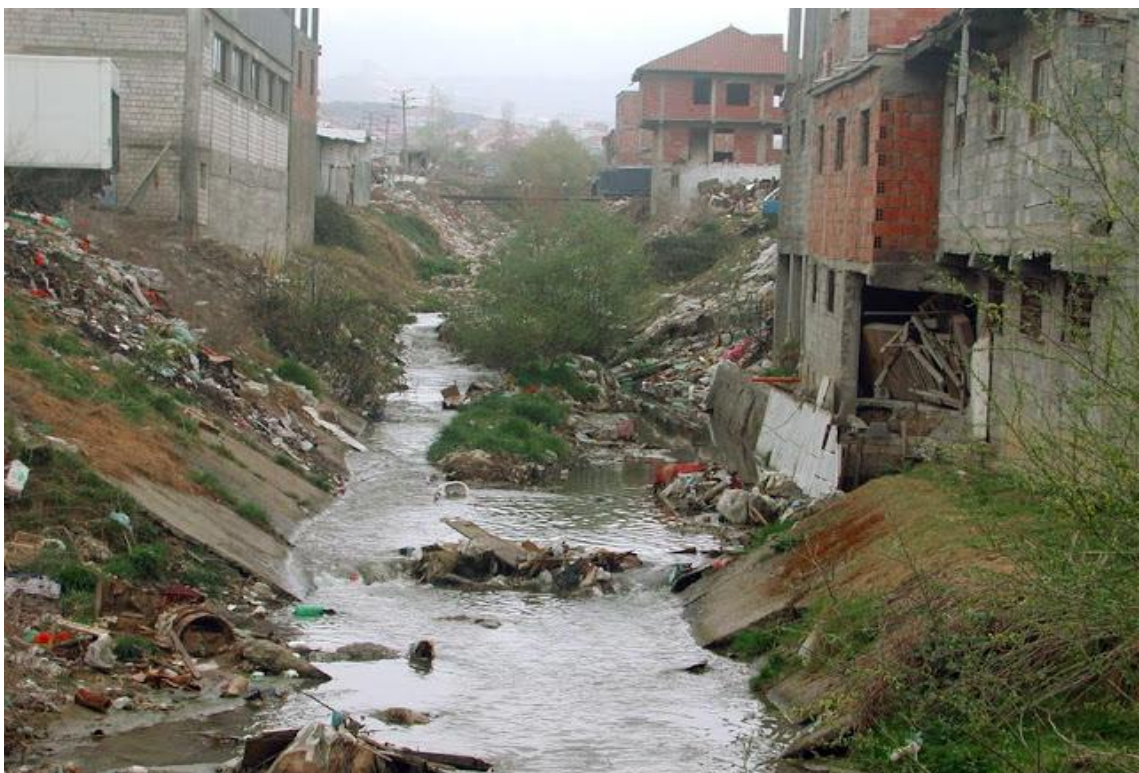
Η κατάσταση του ποταμού πριν το έργο της αποκατάστασης (πηγή: www.panoramio.com )
