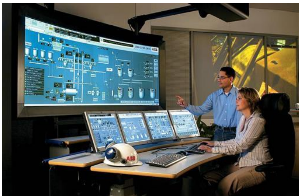
Σχήμα 2.5 Κεντρικός σταθμός Scada
