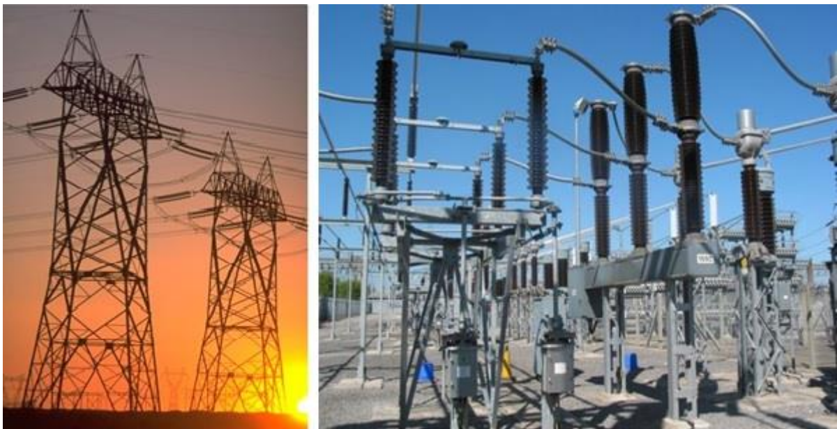
Σχήμα 1.1 Γραμμές ΥΤ και Υποσταθμός Μεταφοράς ΥΤ
