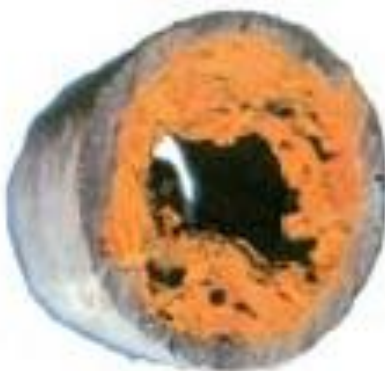
Εικόνα 1-20: Ο χαλυβδοσωλήνας χωρίς αφαίρεση της εσωτερικής κρέμασης της συγκόλλησης δημιουργεί προϋποθέσεις για επικαθίσεις των ορυκτών αλάτων του νερού (νιτρικά, θειούχα φωσφορικά, χλωρικά άλατα και ιόντα νατρίου).
