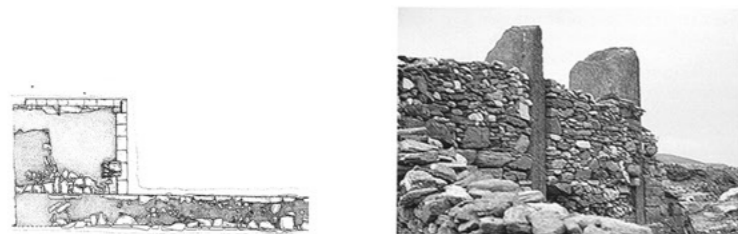
12_ μοναδικό σωζόμενο τμήμα του αρχαίου τείχους, θέση Δύο Πλάκες αποτύπωση και φωτογραφία
