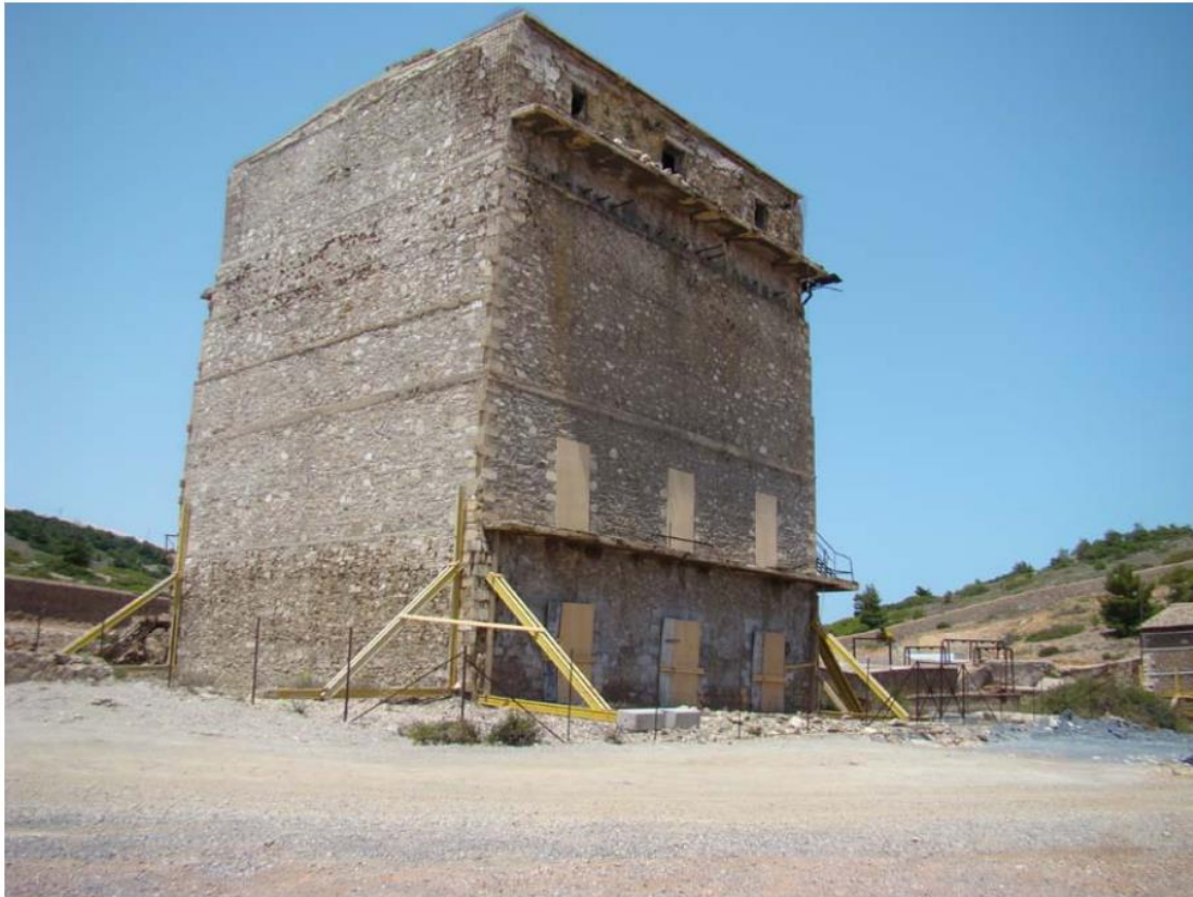
Εικόνα 14: Το κτίριο του Κονοφάγου. (Δ.-Μ. Μαυρομιχάλη με τίτλο «Κοστολόγηση κατασκευής υπογείου χώρου αποθήκευσης επικίνδυνων αποβλήτων στο Τ.Π.Π.Α.», 2010)
