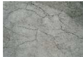
Εικ. 14: Πλέγμα ρωγμών
