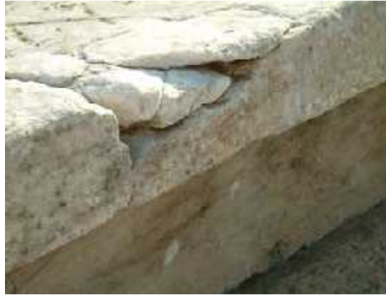
Εικ.22: Θραύση και ετοιμορροπία
