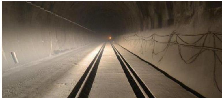
Εικόνα 33: Ολοκληρωμένη υποδομή υπογείου σιδηροδρόμου ΠΗΓΗ: www.academia.edu
